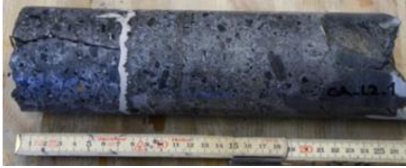
Şekil 3. Püskürtme beton tünel kaplamasından alınmış karot numunesi; ikincil kaplamada 0.8-1.0 mm genişliğinde kalıcı çatlak (Holter, 2015)
