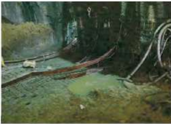
Şekil 23. Deforme olan geçici invertin desteklenmesi
