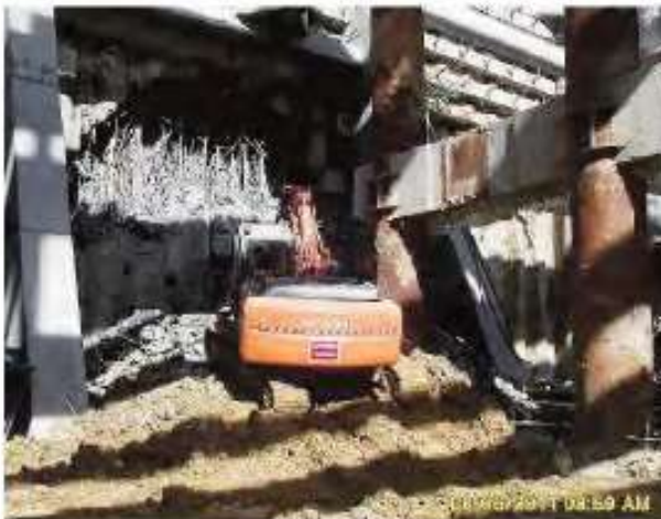
Şekil 6. Tünel girişindeki fore kazıkların kırılması
