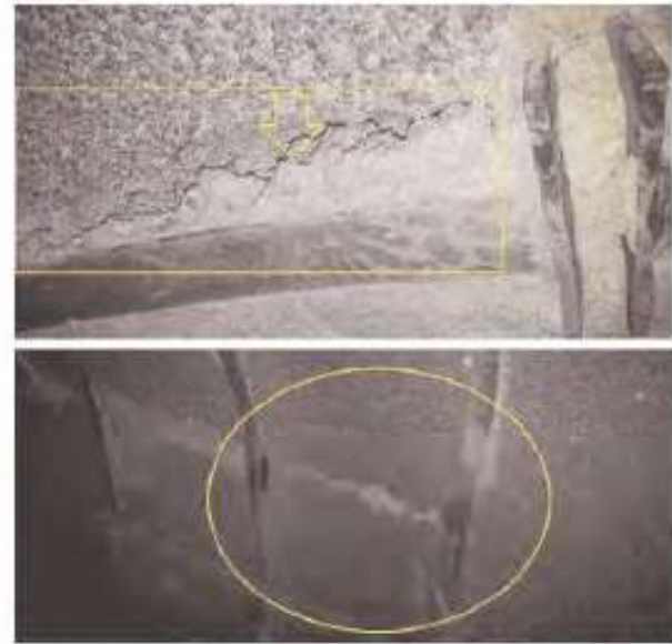
Şekil 6. Püskürtme beton ve çelik iksada meydana gelen deformasyonlar
