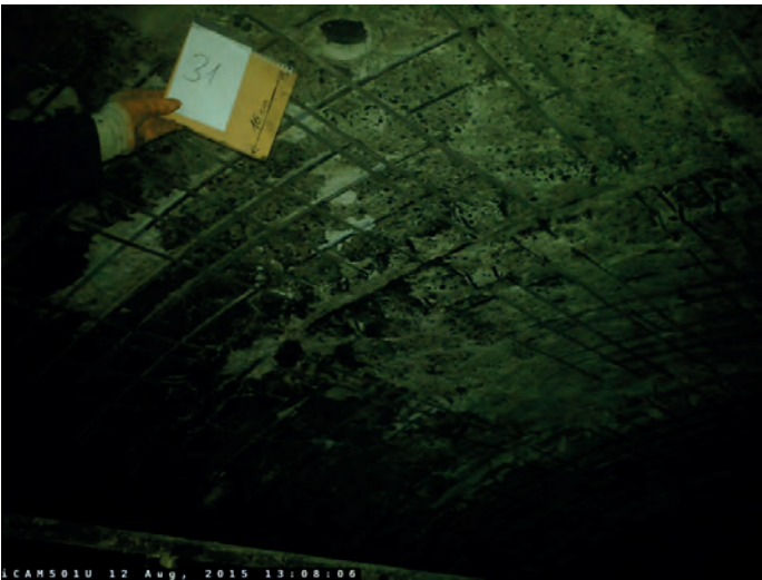
Şekil 10. Tünel tavanında yangına bağlı gözlenen beton dökülmeleri ve donatıların durumu.
