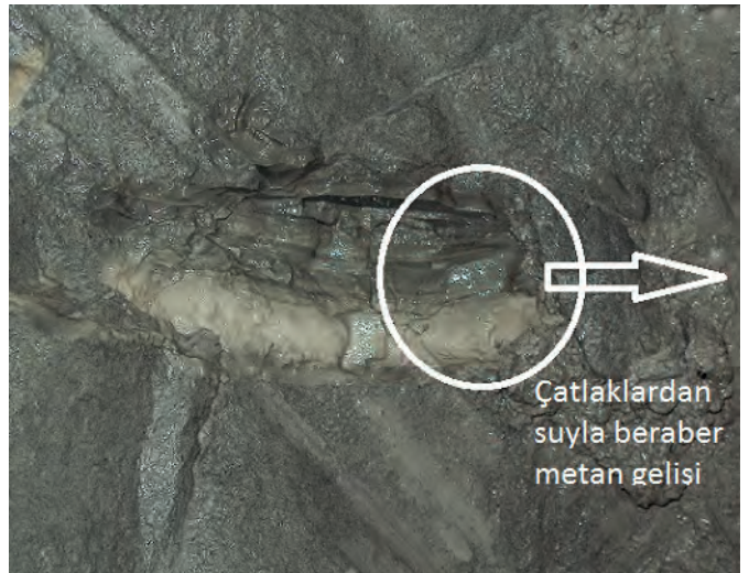
Şekil 11. Selimpaşa tünelinde suyla beraber metan kabarcıklarının dışarı çıkışı.
