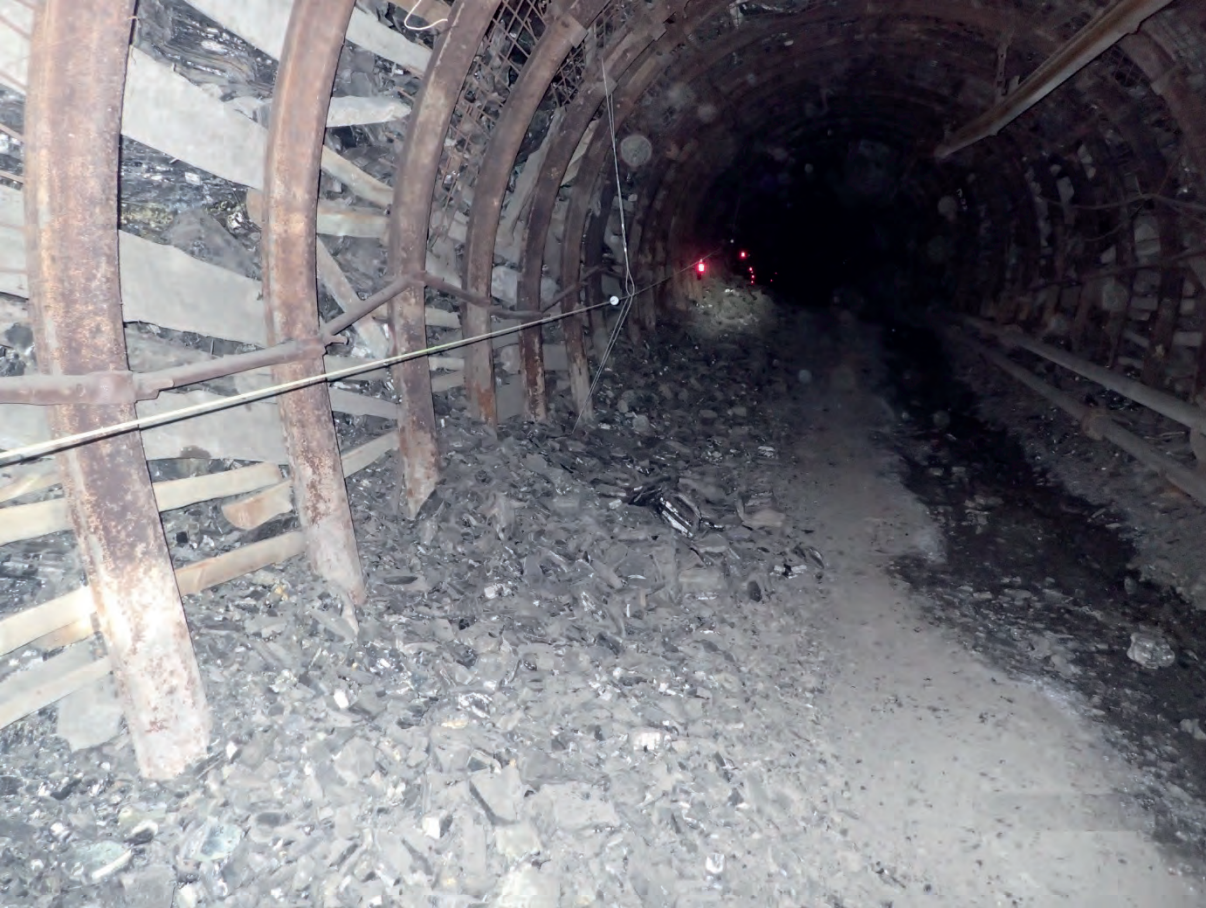
Şekil 3. A-101 Galerisinde gözlenen hasarlar
