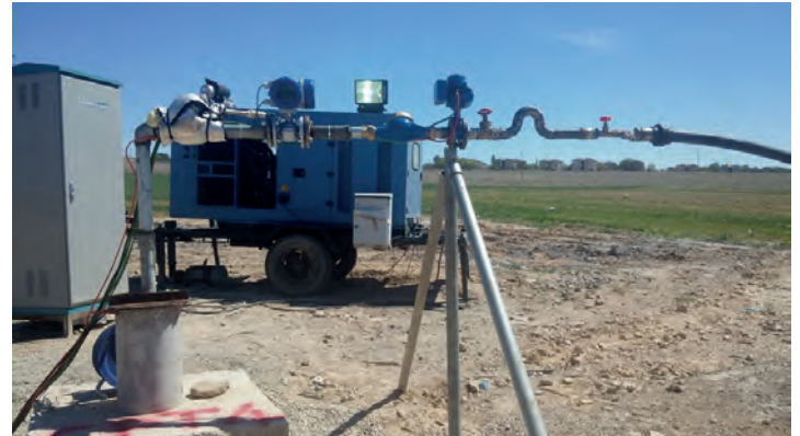
Foto. 2. CPT-4 nolu grubun pompaj kuyusunda pompa testi için kurulan sistem.
