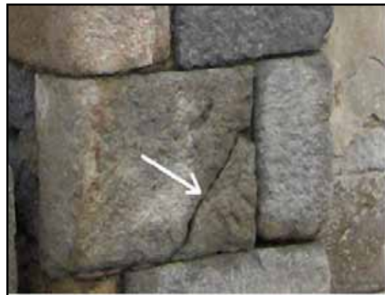
Şekil 8. Abdi Kadı çeşmesindeki volkanik kayaçlarda oluşan çatlaklar.
