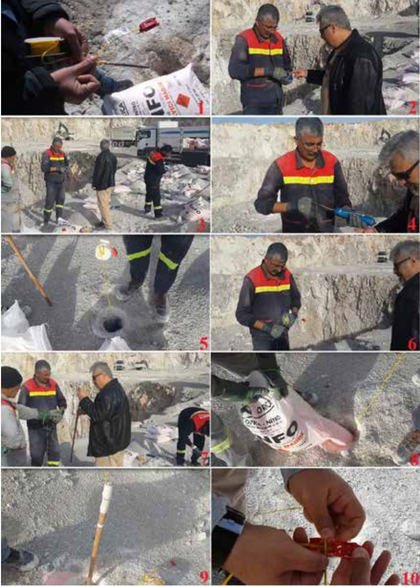
Şekil 13. Elektronik ateşleme sistemi esnasında deliklerin hazırlanması: (1): elektronik kapsül görünümü, (2): elektronik kapsülün dinamite yerleştirilmesi, (3): elektronik kapsülün dinamite yerleştirilmesi, (4): elektronik kapsülün dinamite yerleştirilme son hali, (5):dinamitin patlatma deliğine yerleştirilmesi, (6) elektronik kapsülün deliğe yerleştirilmesinin son hali, (7): sıkılama boyunun ayarlama çubuğu, (8): ANFO'nun doldurulması, (9): sıkılama boyunun ayarlanması, (10): elektronik kapsüllerin hat kablosunda bağlanması
