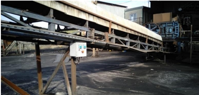
Şekil 2. Tesis içi kömür nakliye bantları
