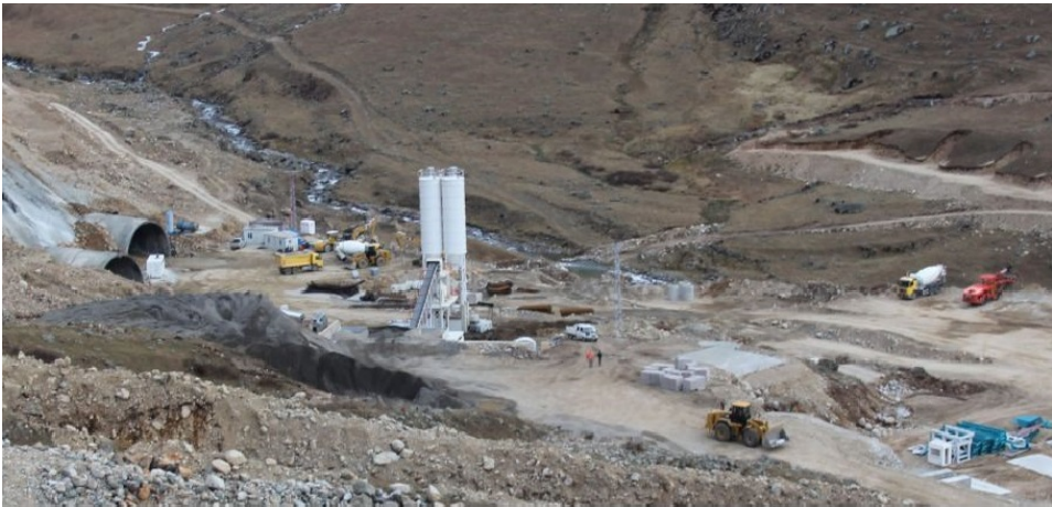
Şekil 20. Tünel için kurulan tesise örnek
