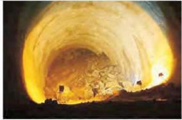
Şekil 3. Tünelde büyük çaplı göçük
