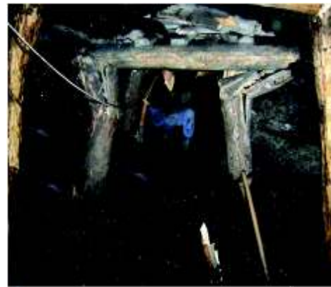
Şekil 7. Uzunayak tahkimatının yetersiz kalması.
