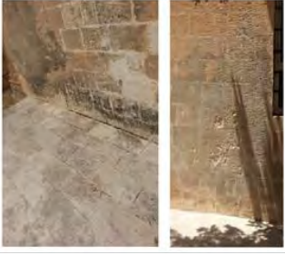
Şekil 6. Duvarda Oyuklu Yüzey Oluşumu
