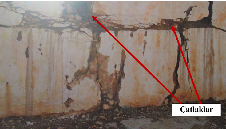
Şekil 10. Yüzeylerde gözlenen iri çatlak oluşumları
