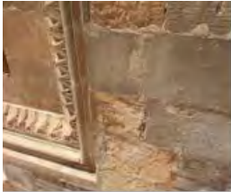
Şekil 3. Duvarda Yüzey Kaybı
