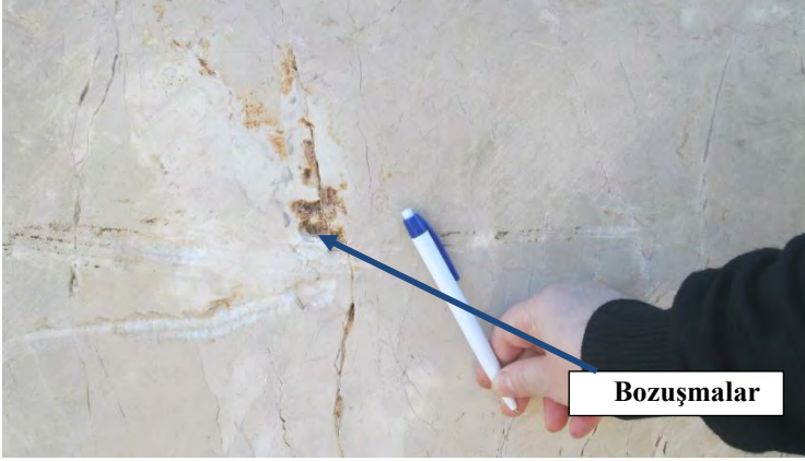
Şekil 14. Yüzeylerde gözlenen bozuşmalar
