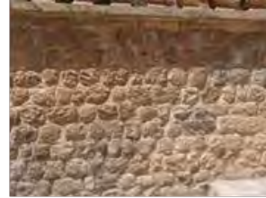
Şekil 5. Duvarda Boşluk - Delik Oluşumu
