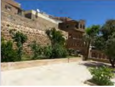
Şekil 15. Dış Duvarlarda Bitki Oluşumu
