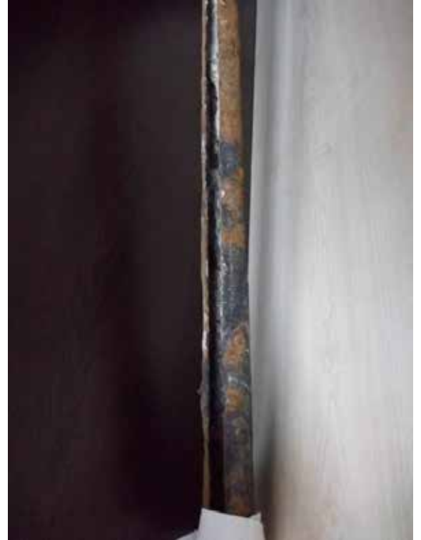
Şekil 3. Korozyona Uğramış Split-Set
