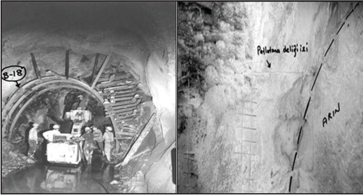
Şekil 8. Kötü sıkılanmış ve kurulması geciktirilmiş rijit bağdaki kesit daralması, hatalı delme-patlatma sonucu aşırı kazı ve aynı galeride gerçekleştirilmiş verimli bir delme-patlatma örneği (Ünlü ve Çolak, 2004, Ünlü, 2005).
