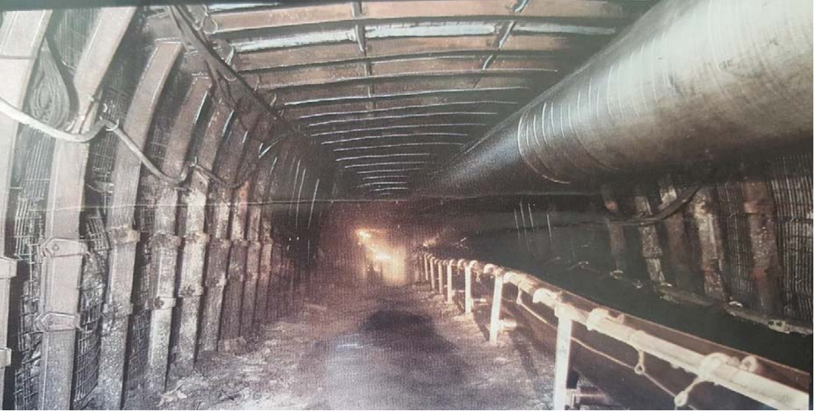
Şekil 3. Tabanyollarında ve galerilerde GI trapez boyunduruk ve TH dikme kombinasyonu.
