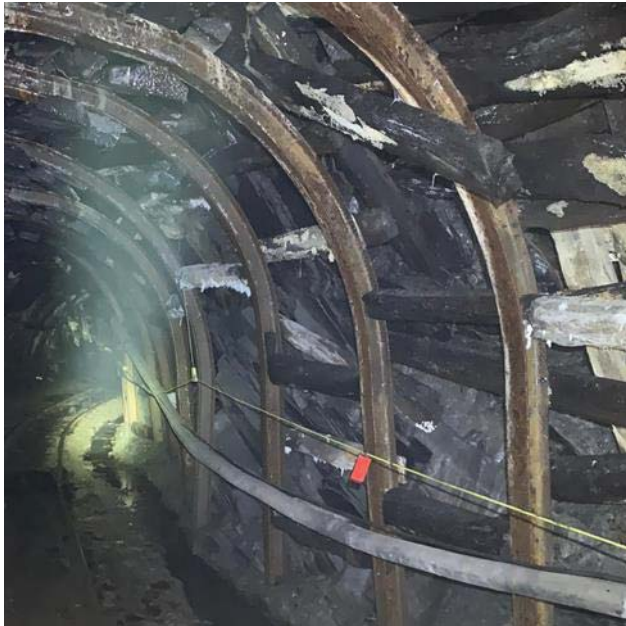
Şekil 6. Akkurt Madencilik 4 Nolu Ocak Ana Nakliye Galerisi demir bağ ve kamalama uygulanmış kısım.
