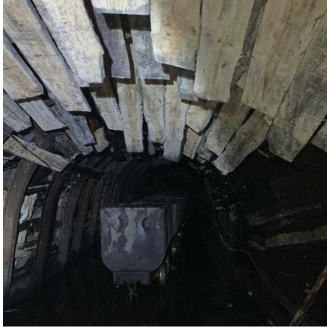
Şekil 8. Akkurt Madencilik 4 Nolu Ocak Ana Nakliye Galerisi demir bağ yapıлып kama ile desteklenmiş bir kısım.
