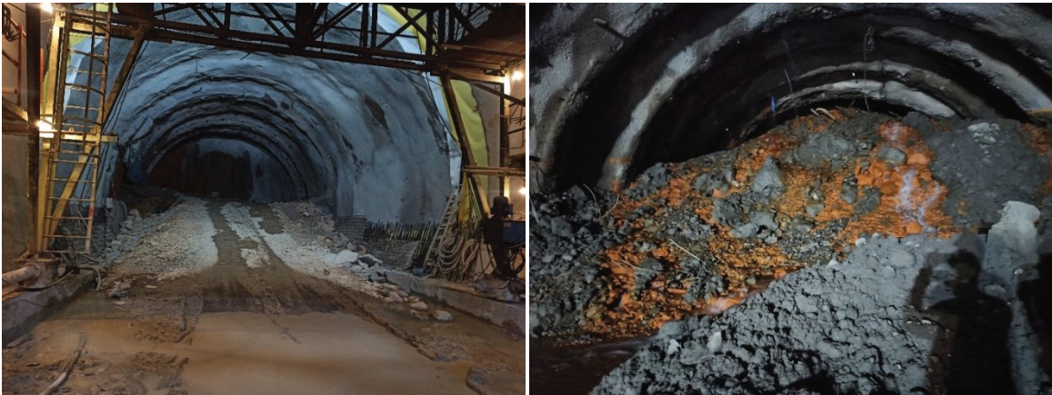
Şekil 3. Tünelde meydana gelen göçük ve iç kaplama betonunun yapılması
