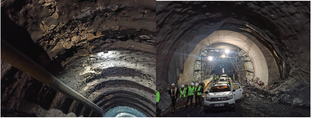
Şekil 2. Tünelde meydana gelen deformasyonlar ve iç kaplama betonunun yapılması
