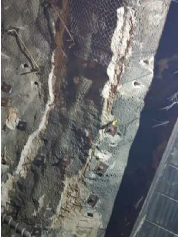
Şekil 21. Üstyarı bölgesinde oluşmuş deformasyona bağlı çatlaklar
