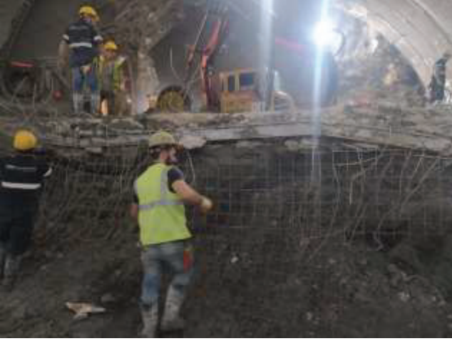
Şekil 16. Üstyarı düz geçici invertte deformasyon
