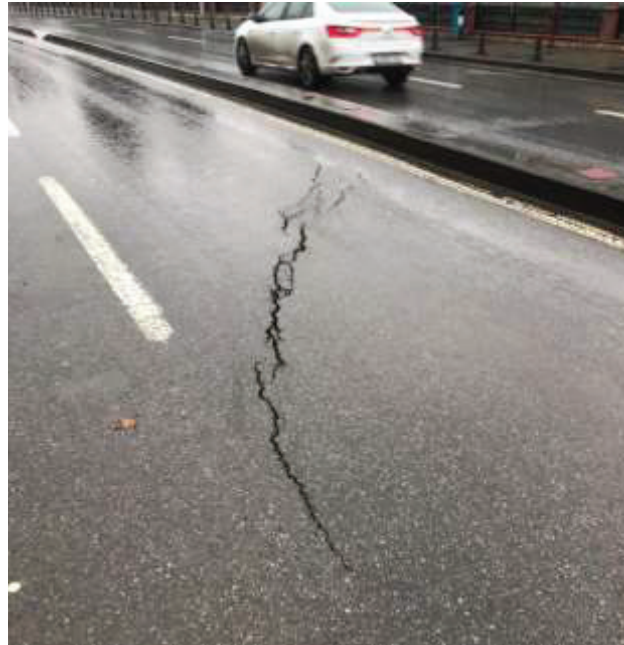
Şekil 8. Sevenler caddesinde gözlenen çatlaklar
