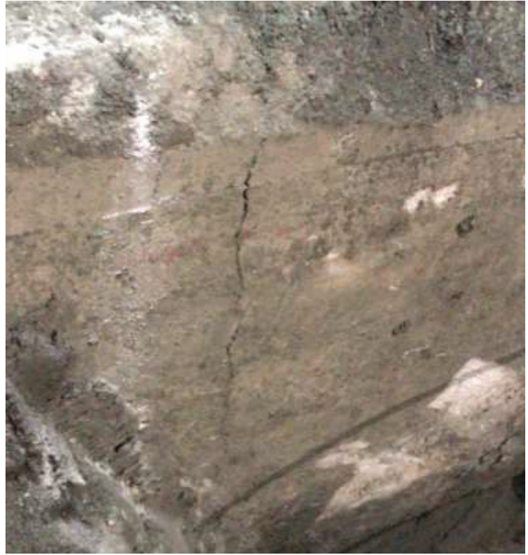
Şekil 22. İnvvert betonunda deformasyona bağlı oluşan çatlak
