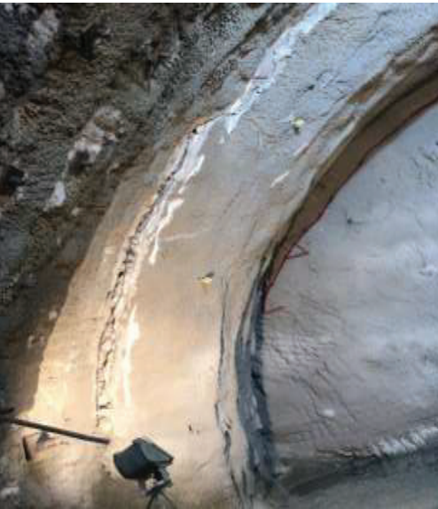
Şekil 11. Bandaj iksa uygulaması öncesi oluşan çatlak
