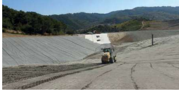
Şekil 25. Dozerle yapılan serimin ardından silindirin sıkıştırma işlemi yaparak alanın yüzey pürüzlülüğünü yok ederek kabuk oluşturması
