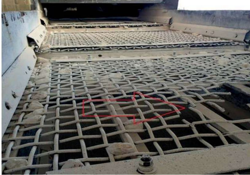
Şekil 6. Yanmış kireç taşı eleme esnasında çelik esaslı elek paneli üzerinde oluşan kopmaların gösterimi
